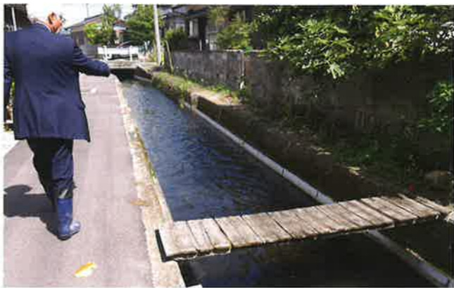
白いFRP(繊維強化プラスチック)板が水路の表面に貼られている。平成16~20年に施工。水路の両側に貼ることで抵抗値を減らし、下流まで行き届かせる対策
